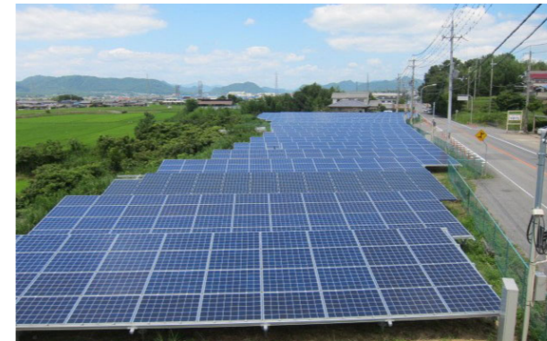
▲お元氣様！発電所1(兵庫県加東市)
