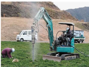
▲バックホウによる先行掘削 ダウンザーホールハンマーは、移動も楽々
