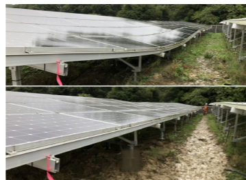
▲地盤沈下により、湾曲してしまった架台とパネル(上:復旧前、下:復旧後)
