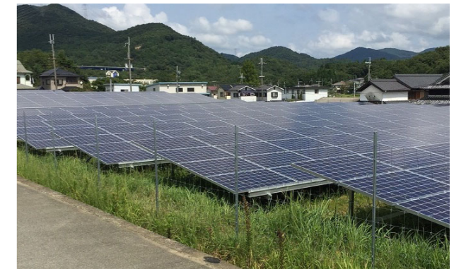
▲お元氣様！発電所3(兵庫三田市)
